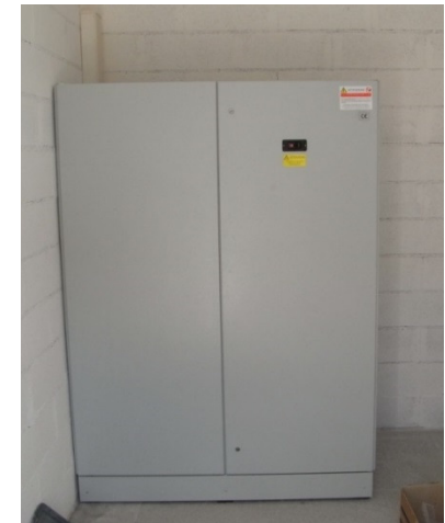
QB – quadro batterie
